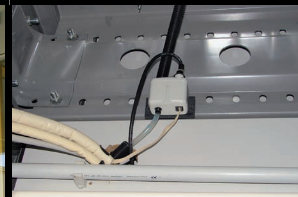
INVISIBILE. Particolare di installazione della pompa in controsoffitto.
